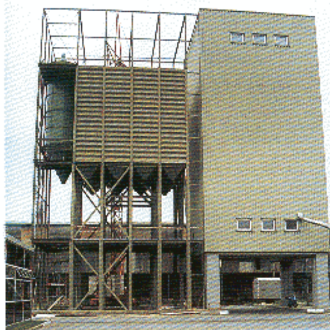
Rohkaffeesilo ohne Verkleidung Silo for Green Coffee without Covering Panels
